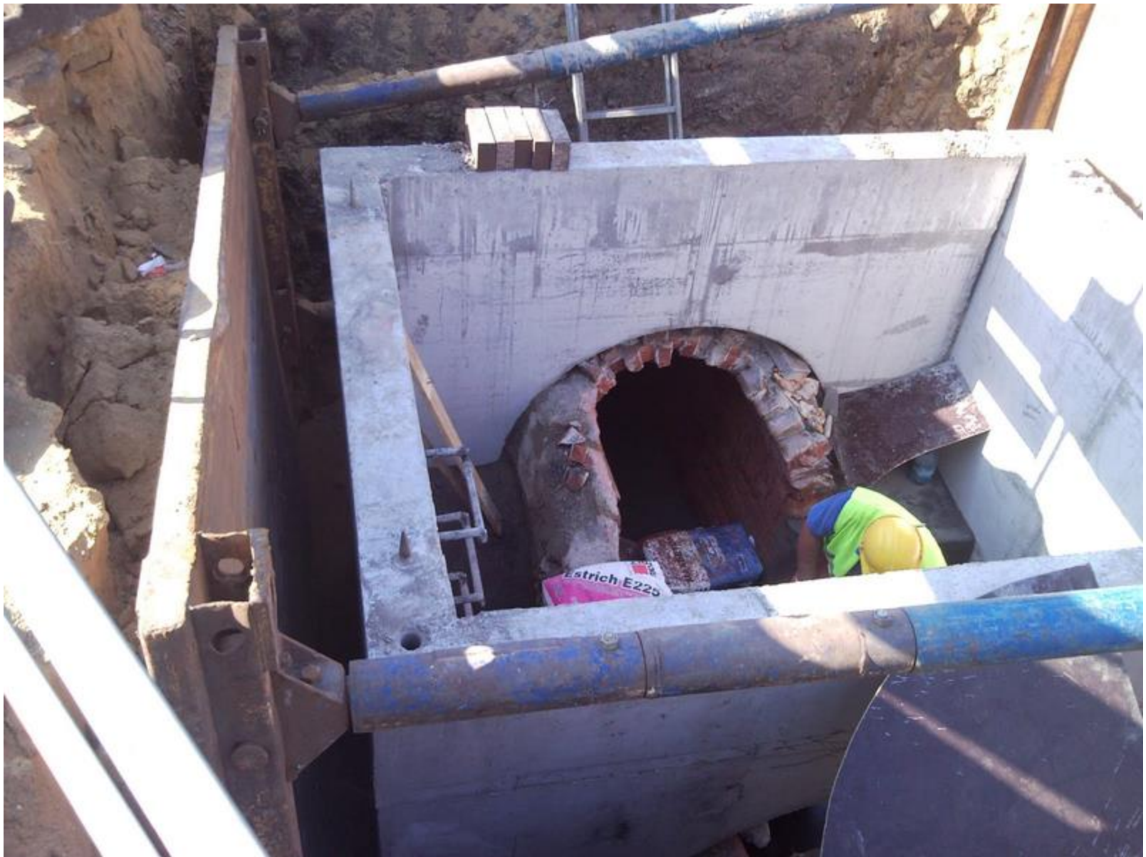
kolektor pod Zaporowską - komora połączeniowa ze Sky Tower
