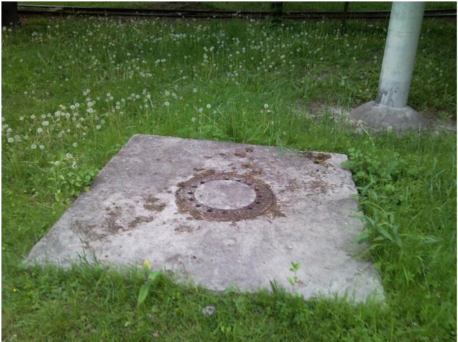
kolektor Ślęza - komora
