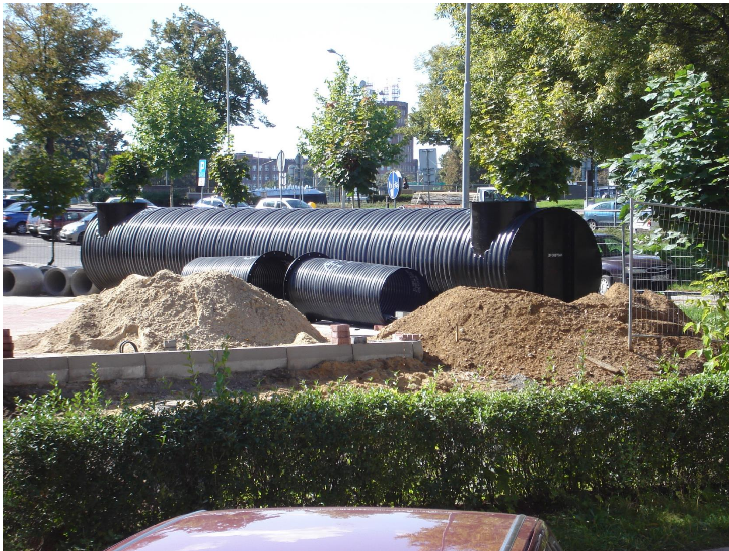
Retencyjny zbiornik jednokomorowy, materiał PE
