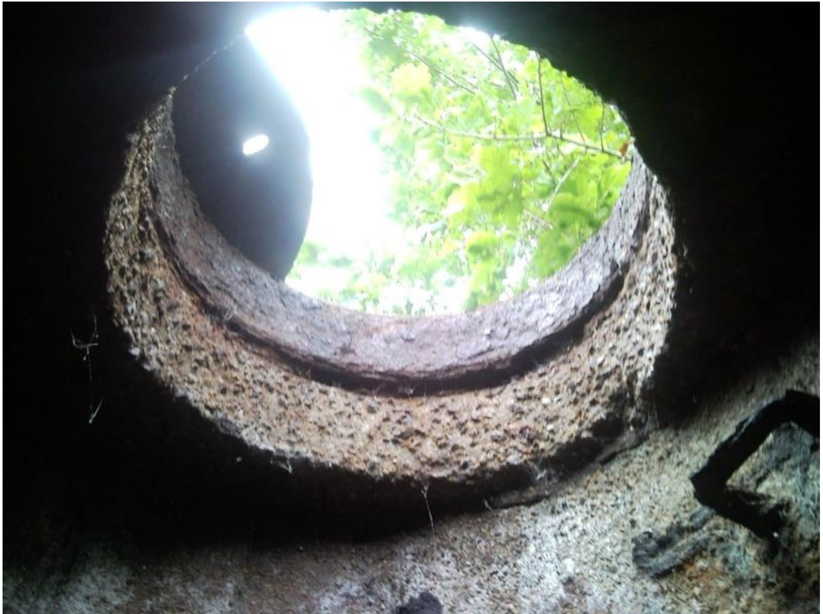
kolektor Odra - właz
