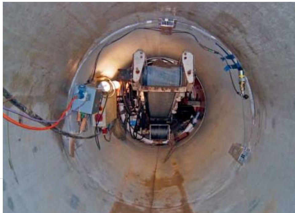
Wbudowany segment rury z ciśnieniomierzem i trzema tensometrami [1]
